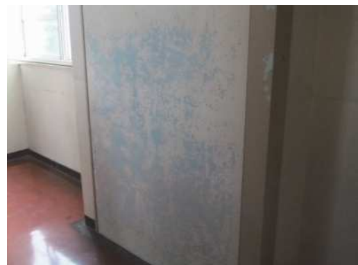
↑ ポロポロと塗膜片が剥がれ落ちる防火扉
