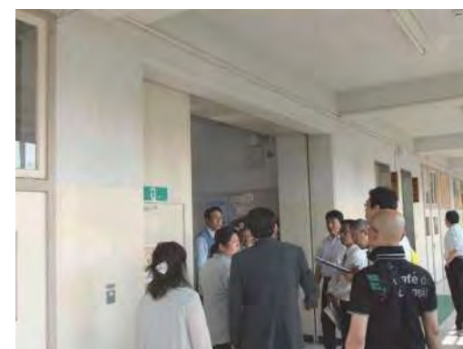
↑防火シャッターの老朽化による誤作動が発生
