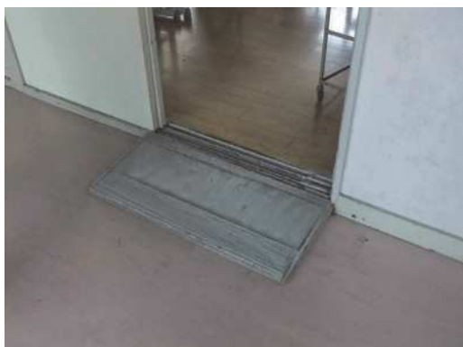
↑各校各所に段差があり、応急的な処置がされている
