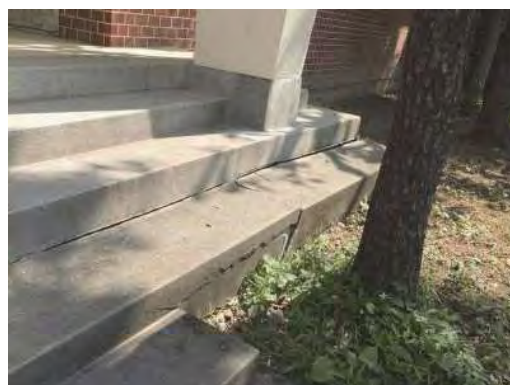
↑地盤沈下?による段差。転倒の恐れ
