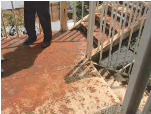
↑非常階段の錆による腐食は避難通路として使えるのか強度的に不安
