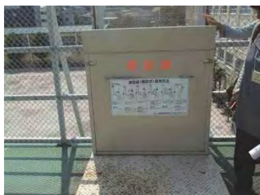
↑屋上に設置されている救助袋。しかし屋上へ 出る扉が施錠されているため緊急時使用不可
