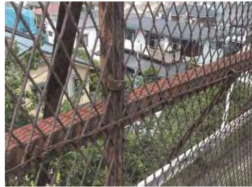
↑屋上フェンスの錆は脱落の危険も！
