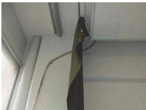
↑プールの排水管からの漏水があり、天井 内にホースを入れ排水
