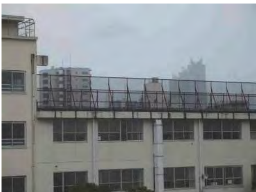
↑ フェンスの下の外壁の汚れは錆汁によるもの
