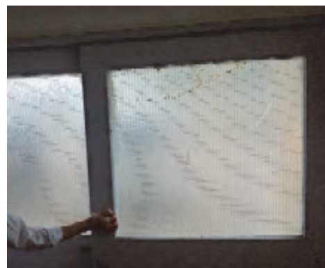
↑屋上に出る扉が老朽の為開閉できず 避難通路として役に立たない
