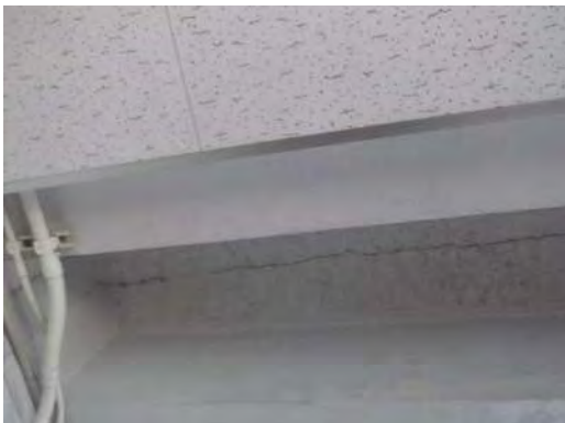
↑ こういった建物のつなぎ目からの漏水箇所も多くみられる
