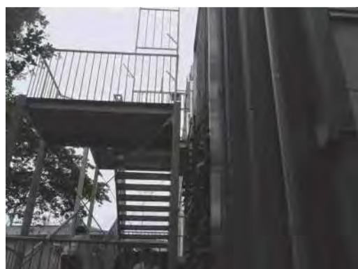
↑非常階段の傾き。避難通路として不安や危険
