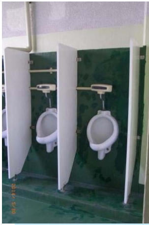
老朽化したトイレ
