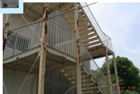
何年もメンテナンス されず、塗装が剥げた 非常階段
