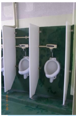
老朽化したトイレ
