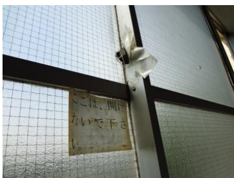
サッシの老朽化 窓を開けられず換気もできない
